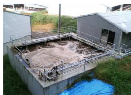
2-(2) 養豚汚水浄化処理施設の適切な運転管理
