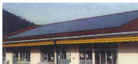
(園舎の屋根に設置された太陽光発電パネル)
