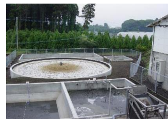
2-(1) 汚水処理施設
