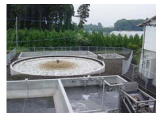
2-(1) 汚水処理施設
