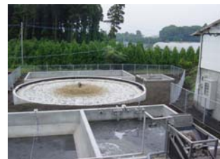
2-(1) 汚水処理施設
