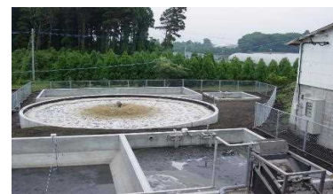
2-(1) 汚水処理施設
