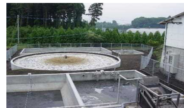
2-(1) 汚水処理施設
