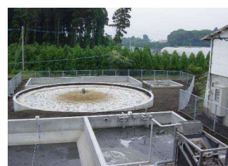
2-(1) 汚水処理施設
