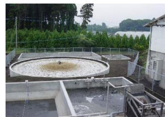
2-(1) 汚水処理施設
