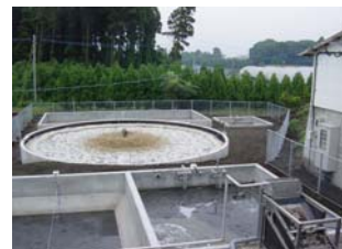
2-(1) 汚水処理施設
