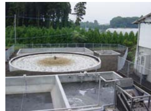
2-(1) 汚水処理施設
