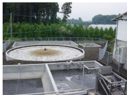
2-(1) 汚水処理施設
