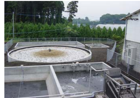
2-(1) 汚水処理施設
